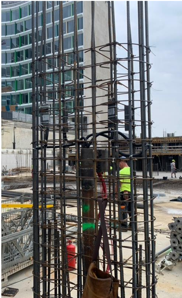
Nyúlásmérők oszlopba építve
