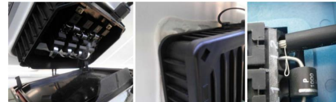
Sérült csatlakozó dobozok
