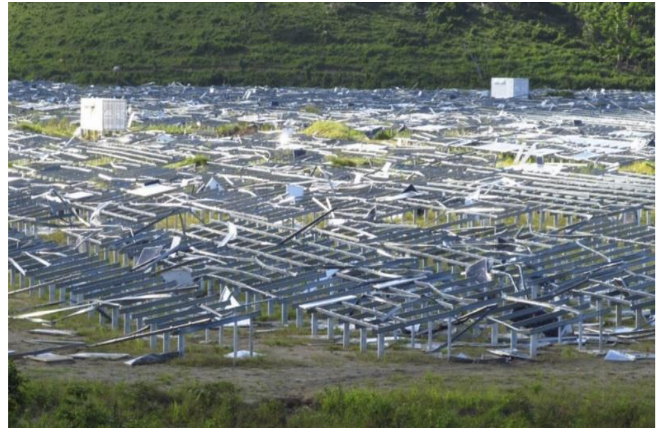
A 2017-es Maria hurrikánban megsérült – és gyakorlatilag tönkrement – Puerto Rico-i napelem park
