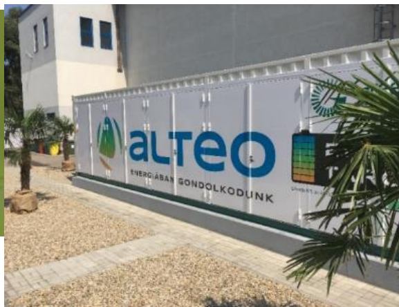
Akkumulátoros villamos energia tároló (kívülről...)
